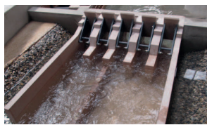
NEPAL | Barrage de Karnali - 1/100 ème Evacuateur de crues vanné
